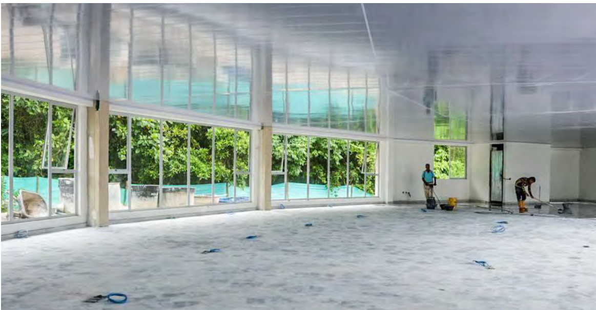
El Centro Integrado de Atención a la Mujer lleva un avance de obra del 80%. / Secretaria de Tics.
